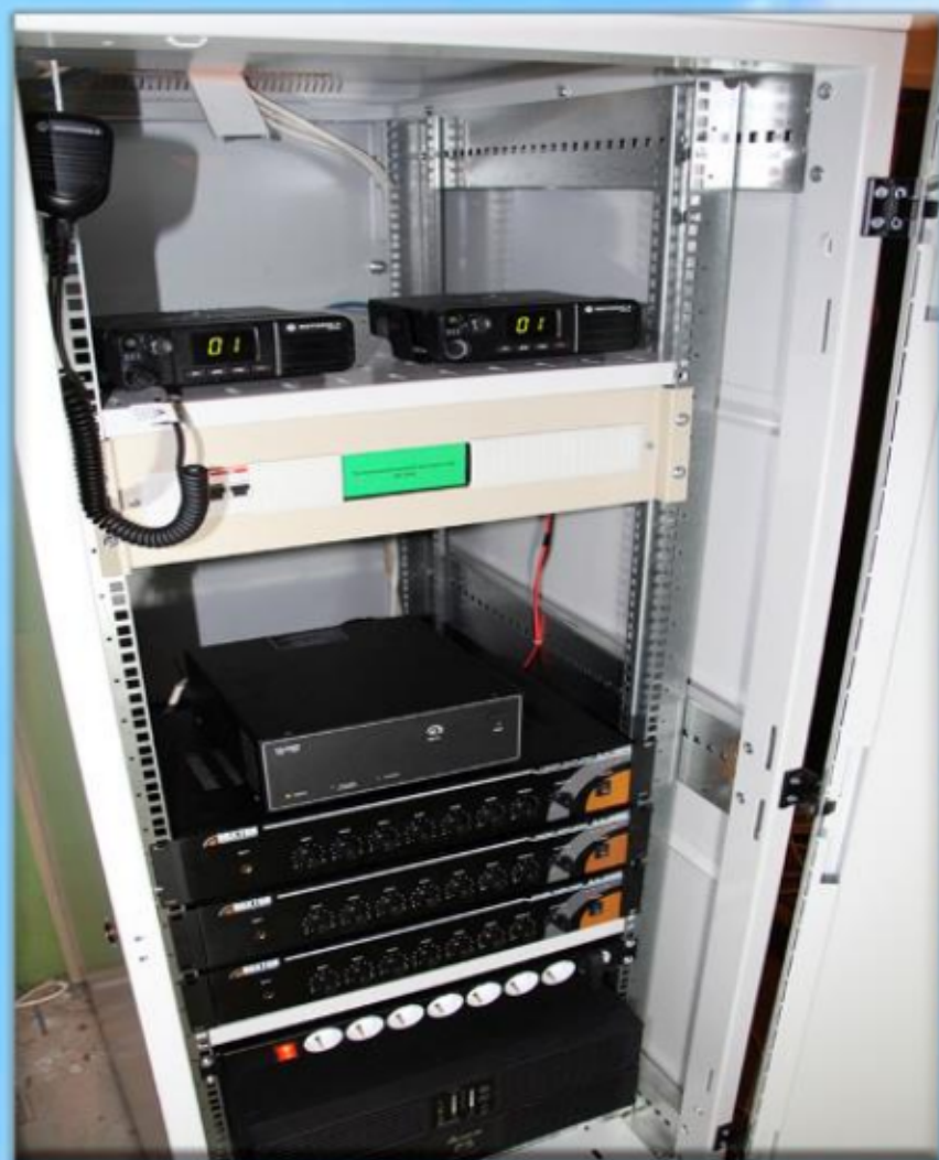
В напольном шкафу
